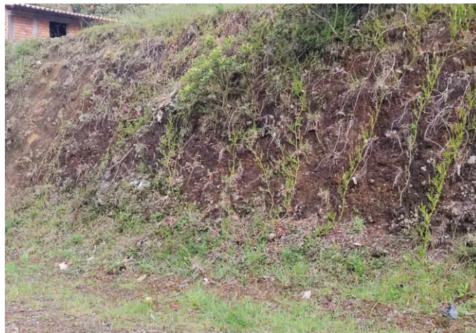
Figura 37. Depósito de deslizamiento, localizado en La Miel. Fuente: Estudio básico de amenazas Caldas (2021)
