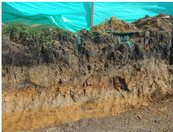
Figura 163. Suelo residual del miembro Volcánico a la altura de La Salada parte baja. Fuente: Estudio básico de amenazas Caldas (2021)
