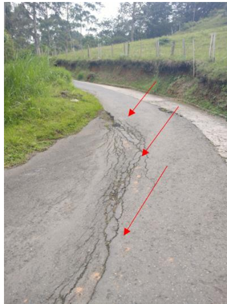
Figura 54. Fenómeno de deslizamiento lento localizado en la vía que va hacia el barrio Andalucía. Fuente: Estudio básico de amenazas Caldas (2021)
