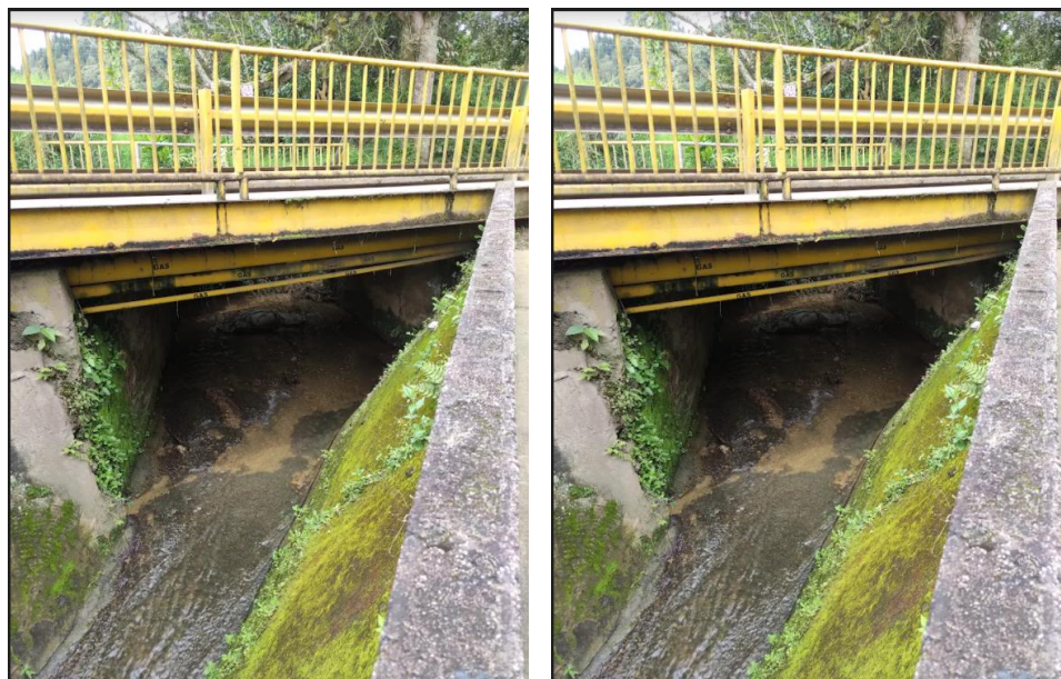
Figura 74. Levantamiento de dimensiones en La Quebrada La Chuscala Fuente: Estudio básico de amenazas Caldas (2021)
