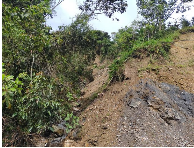
Figura 59. Deslizamiento superficial Vereda Sinifaná. Fuente: Estudio básico de amenazas Caldas (2021)
