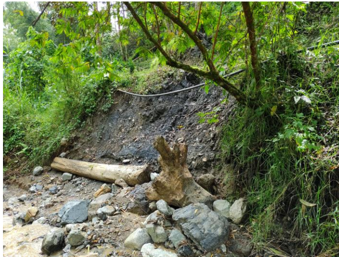
Figura 61. Socavación Lateral quebrada La Raya. Fuente: Estudio básico de amenazas Caldas (2021)
