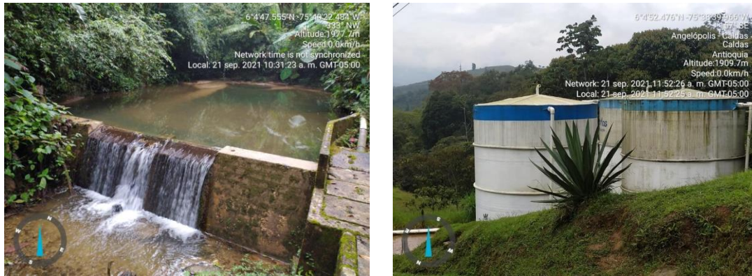
Figura 7-12. Captación del acueducto La Chuscala, quebrada Cañada Honda. Fuente: Informe técnico 160AS-IT2112-15084 del 14 de diciembre de 2021.
