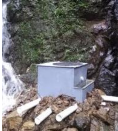
Figura 7-15. Captación del acueducto de la JAC La Raya.
