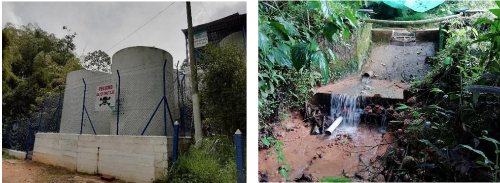
Figura 7-7. Captación del acueducto ASDAR.
