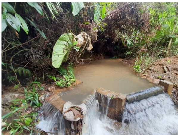
Figura 7-8. Captación sobre la quebrada La Chuscala acueducto Mandalay. Fuente: Proyecto 8- AMVA 2021.
