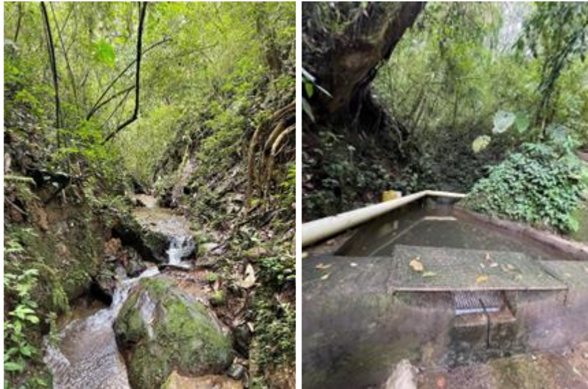
Figura 7-9. Fuente de abastecimiento y estructura de captación del acueducto Primavera. Fuente: Informe Técnico 160AS-IT2306-7604 del 23 de junio de 2023.
