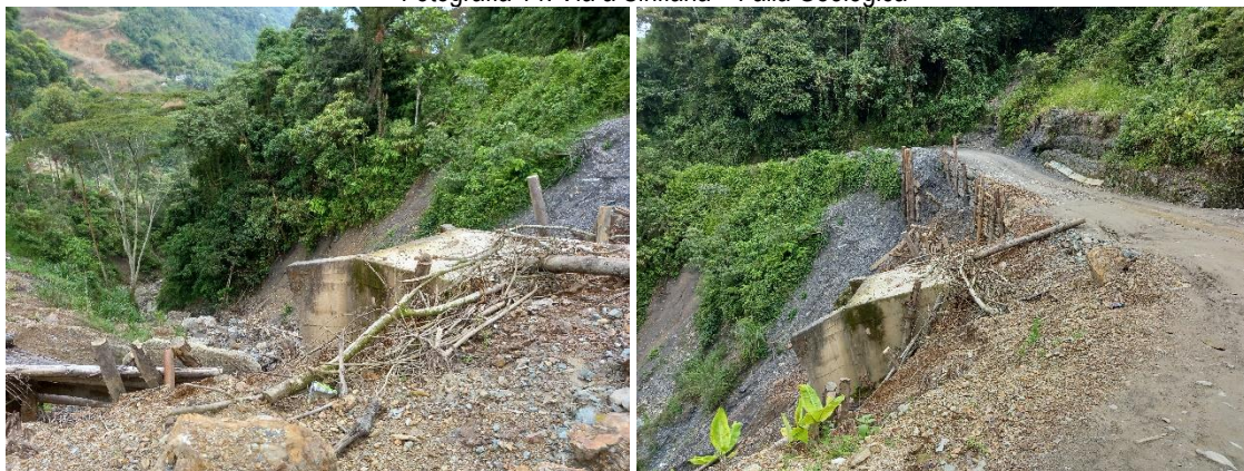
Fotografía 14. Vía a Sinifaná – Falla Geológica
