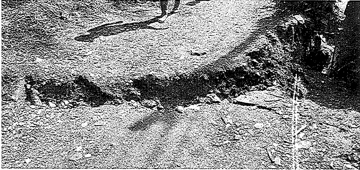
Imagen N°2 grieta en la via ferrea.
