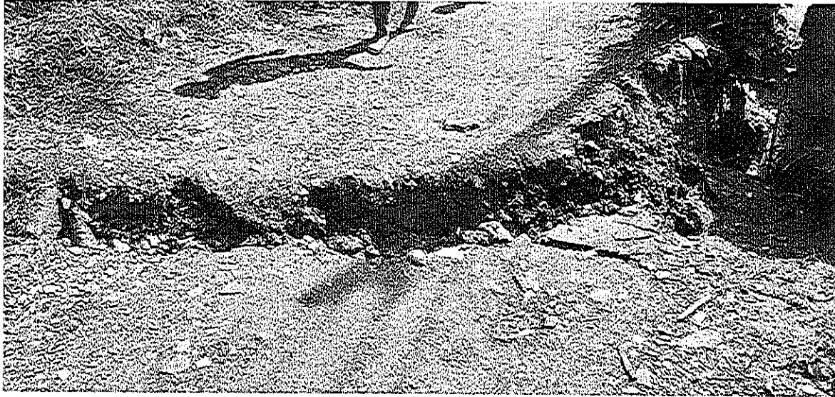
Imagen N°2 grieta en la via ferrea.
