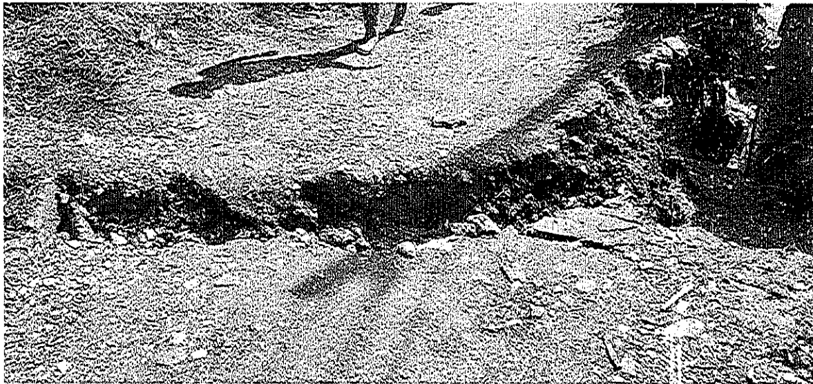
Imagen N°2 grieta en la via ferrea.
