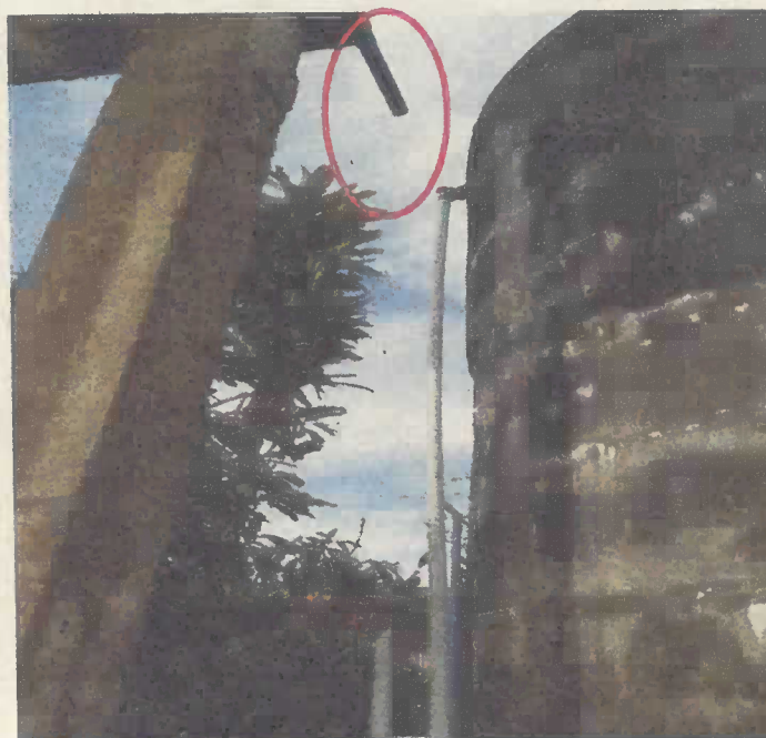
Ilustración 1 Evidencia de la desconexión del tanque
